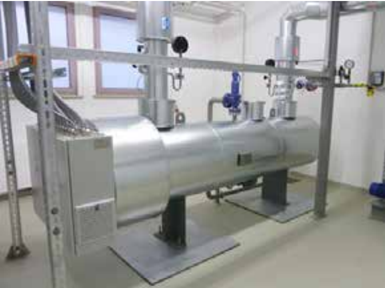
Power-to Heat Anlage 1,2 MW / 400 V für Wärmeversorgung eines Nahwärmenetzes in Delitzsch.
